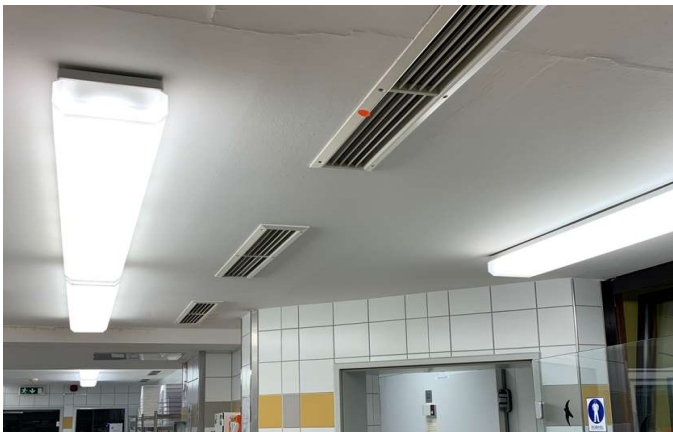
Grundbeleuchtung Küche ca. 21Stk. x2 x 58W
