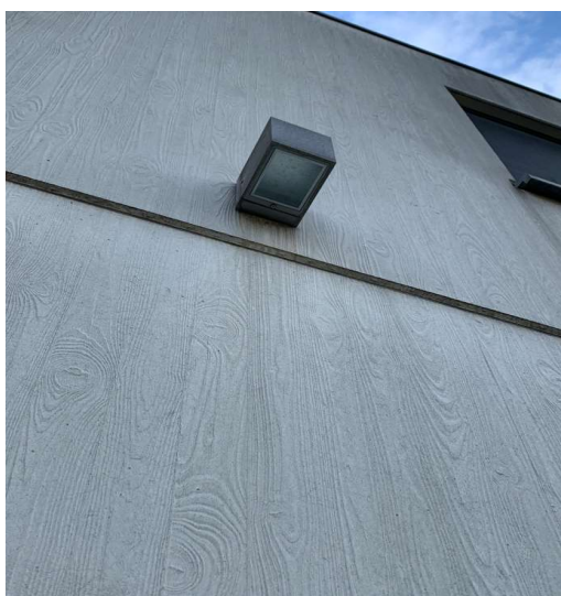
Außenbeleuchtung ca. 8Stk.
