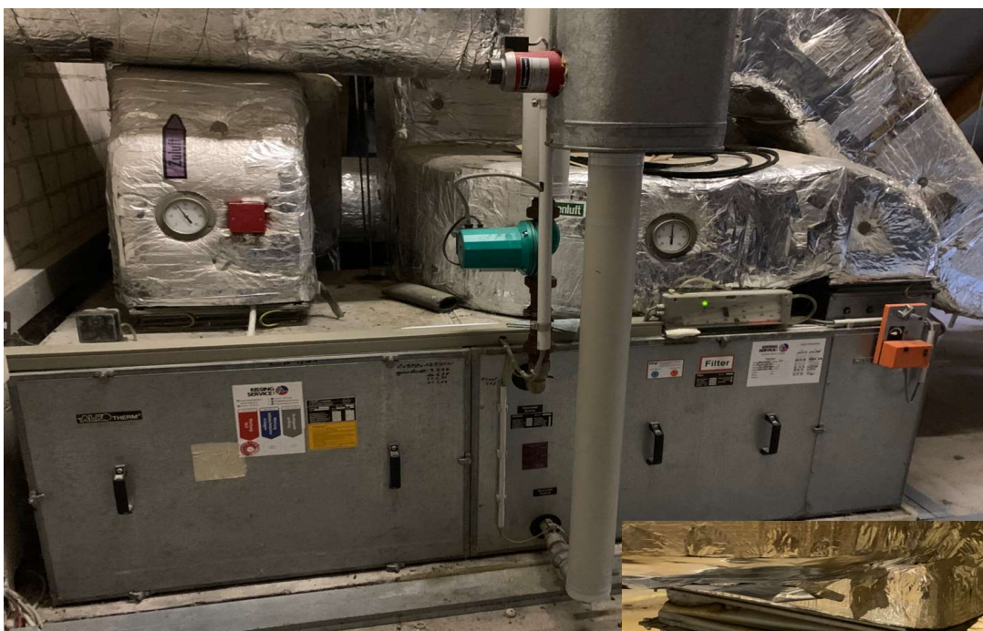
(oben) Zuluftanlage Baujahr 1990 ohne WRG (rechts) einfacher Abluftventilator nach außen
