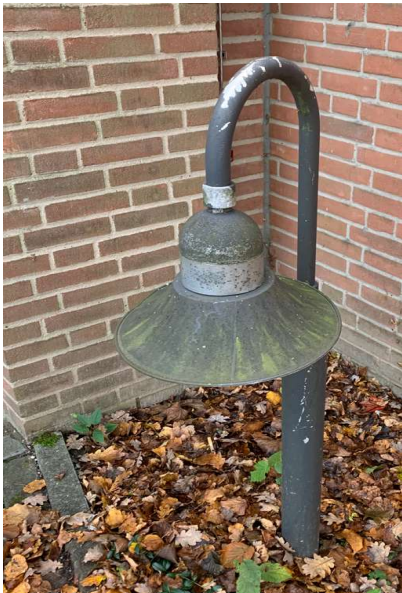
Außenbeleuchtung ca. 6Stk.
